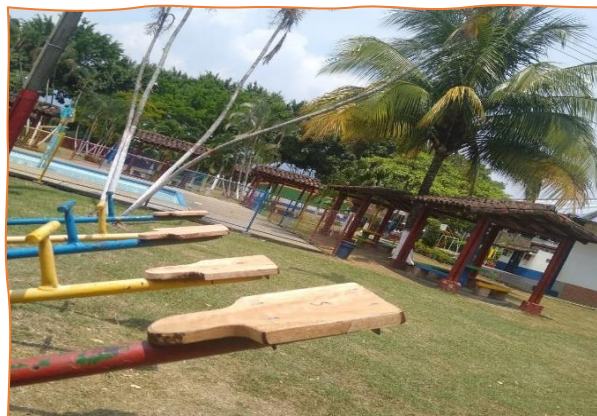
Adecuación de balancines juegos infantiles
